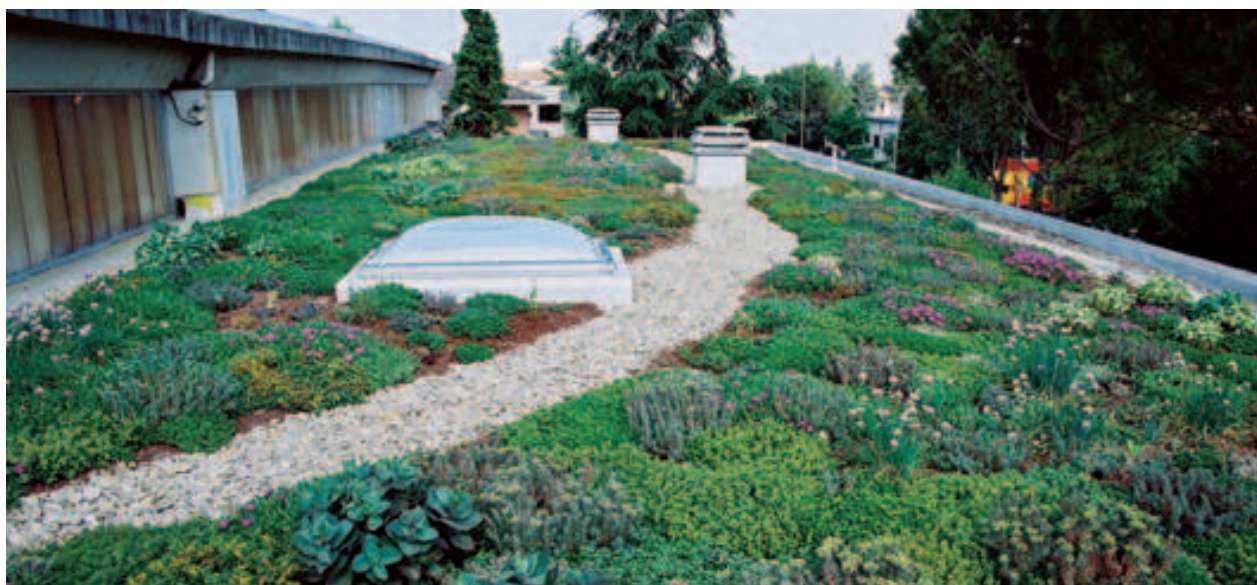
Tetto Verde su copertura azienda Co.Pa.Ri. a Forlì (FC), Fonte DAKU Italia
