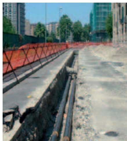
Rete di teleriscaldamento nel quartiere di via Arquata, Torino
